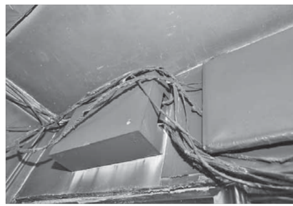
Проводка нуждается в замене
