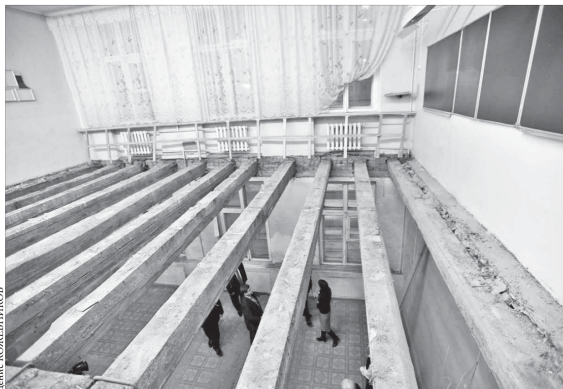
Деревянные перекрытия на ладан дышат
