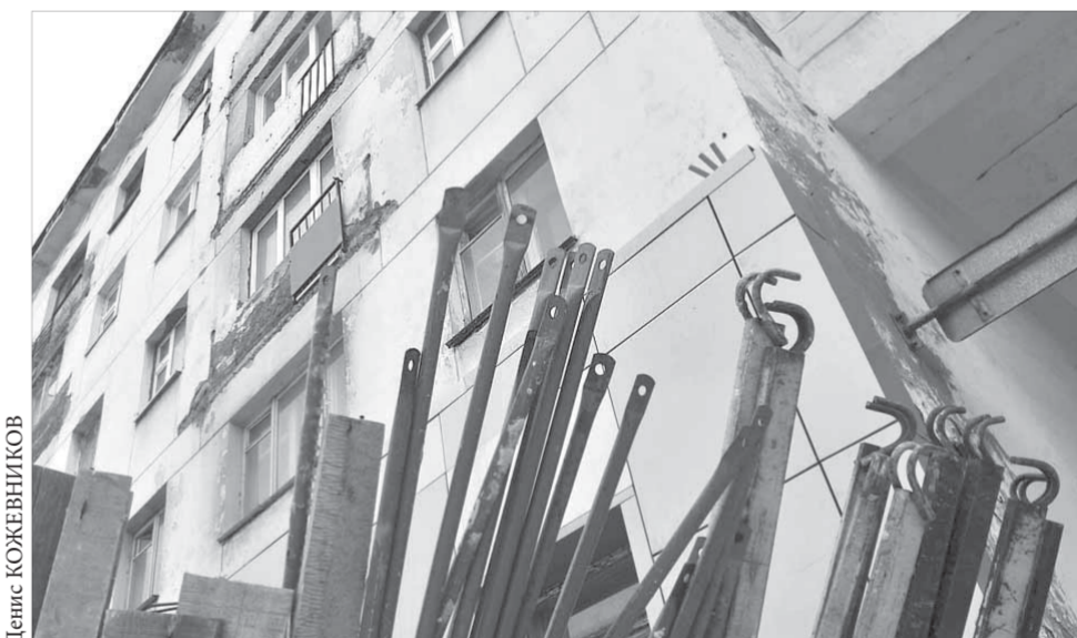
Перед ремонтом фасадов в девяти хрущевках срежут аварийные балконы
