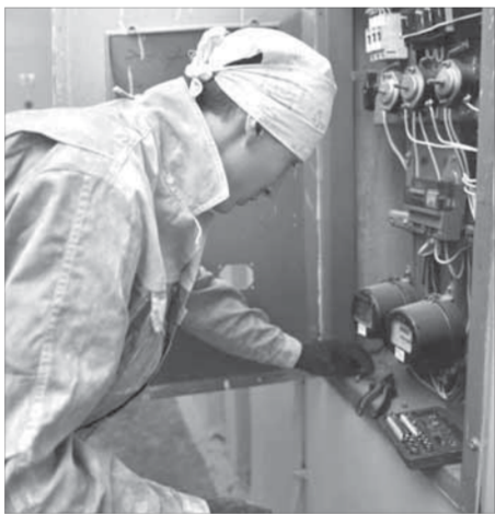
Внутридомовая система электрооснабжения тоже часть общедомового имущества
