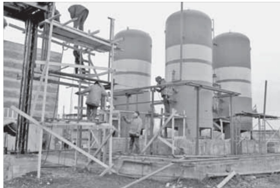
Ресиверы установлены. ТЭЦ начинает работать в штатном режиме
