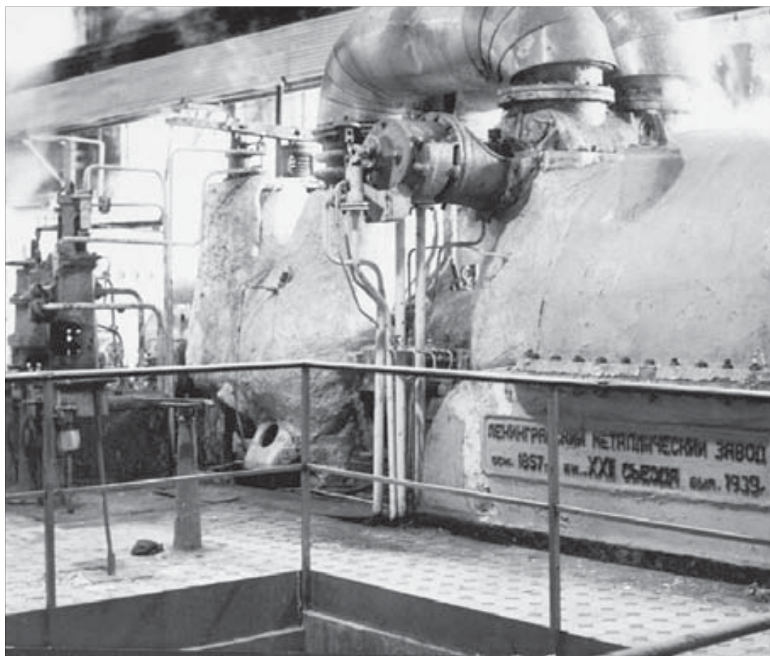
Турбинный зал ТЭЦ-1. 1991 г.
