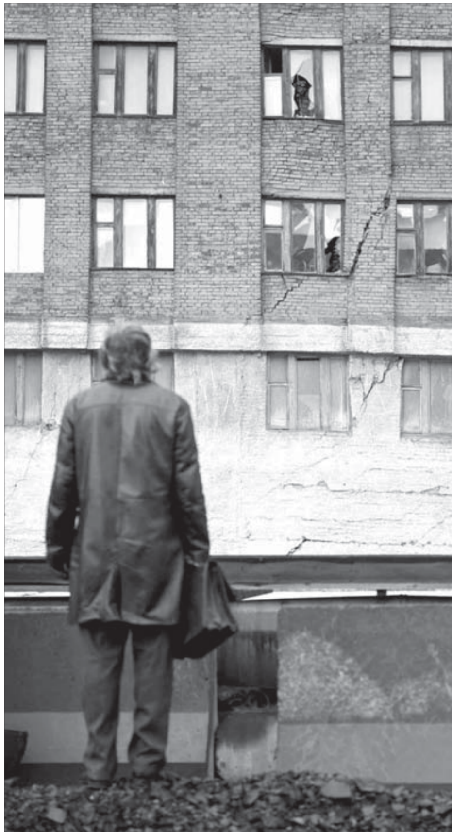
В поврежденное крыло здания до сих пор никого не пускают
