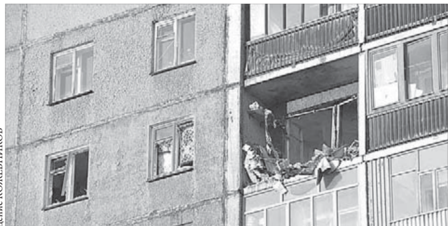
Взрывная волна разрушила балкон
