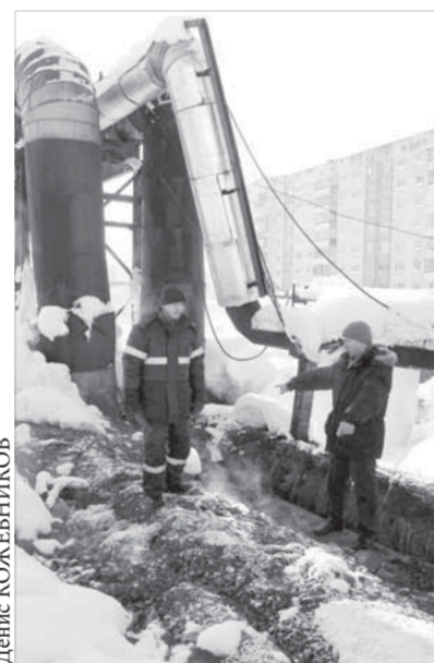
Свищ на подающем трубопроводе больше нет
