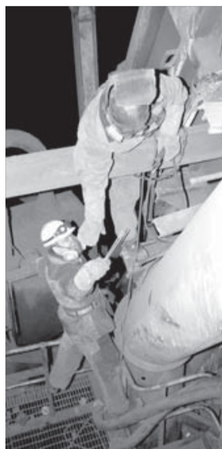
Идет работа на конвекторе
